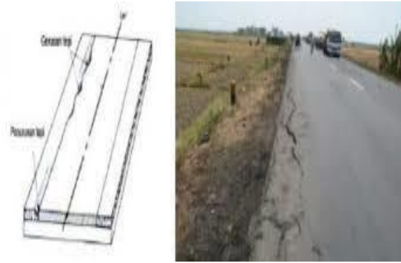
Gambar 2.8 Retak Pinggir ( Edge Cracking )
