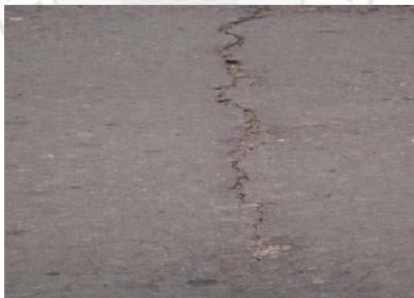
Gambar 2.10 Pinggiran Jalan Turun Vertikal ( Lane/Shoulder Drop Off ) Sumber: Fitri (2022)
