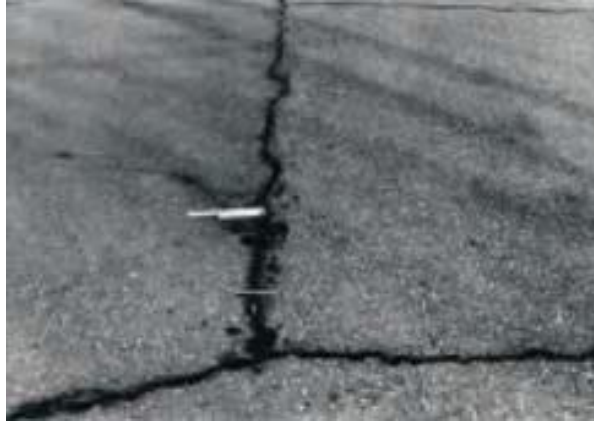
Gambar 2.9 Retak Sambung ( Joint Reflection Cracking ) Sumber: Fitri (2022)
