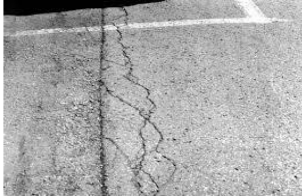
Gambar 2.11 Retak Memanjang/Melintang ( Longitudinal/Transverse Cracking ) Sumber: Fitri (2022)
