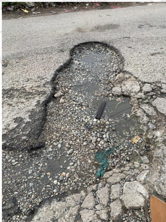
Gambar.4 Jenis Kerusakan Lubang (Sumber : Hasil Analisis, 2026)
