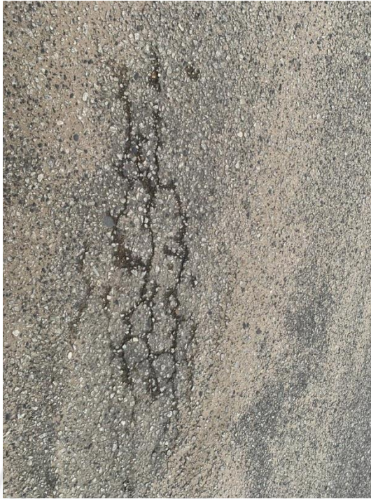
Gambar.3 Jenis Kerusakan Retak Buaya (Sumber : Hasil Analisis, 2026)
