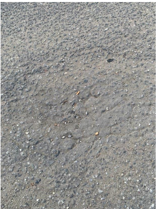
Gambar.7 Jenis Kerusakan Amblas (Sumber : Hasil Analisis, 2026)
