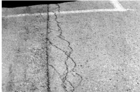
Gambar 2.11 Retak Memanjang/Melintang ( Longitudinal/Transverse Cracking ) Sumber: Fitri (2022)
