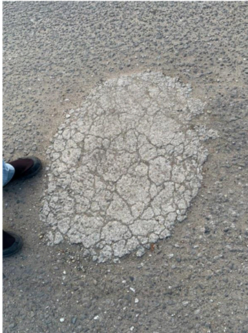
Gambar 73 Jenis Kerusakan Tambalan (Sumber : Hasil Analisis, 2026)
