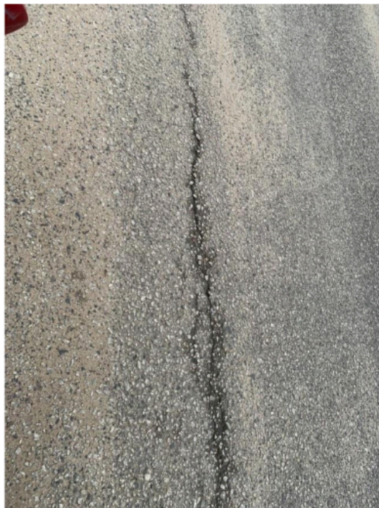
Gambar.2 Kerusakan Retak Memanjang/Melintang (Sumber : Hasil Analisis, 2026)
