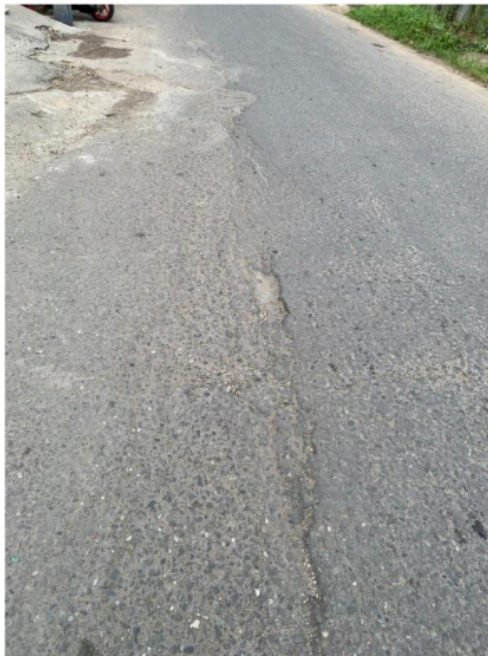
Gambar 100 Jenis Kerusakan Retak Pinggir (Sumber : Hasil Analisis, 2026)
