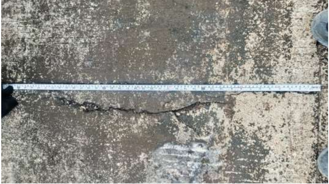
Pengukuran Panjang, lebar dan Kedalaman Kerusakan
