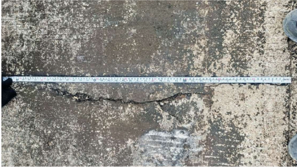
Pengukuran Panjang, lebar dan Kedalaman Kerusakan
