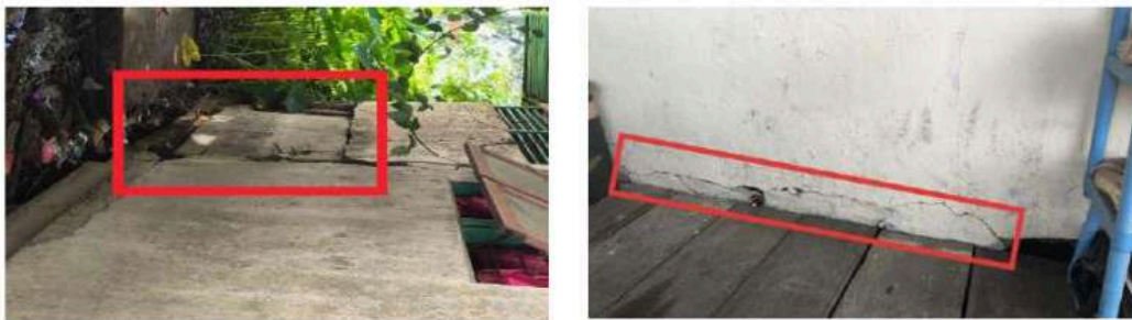
Gambar 4. 6 Kondisi Kerusakan Pada Dinding
