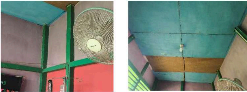
Gambar 4. 5 Kondisi Kerusakan Pada Balok
