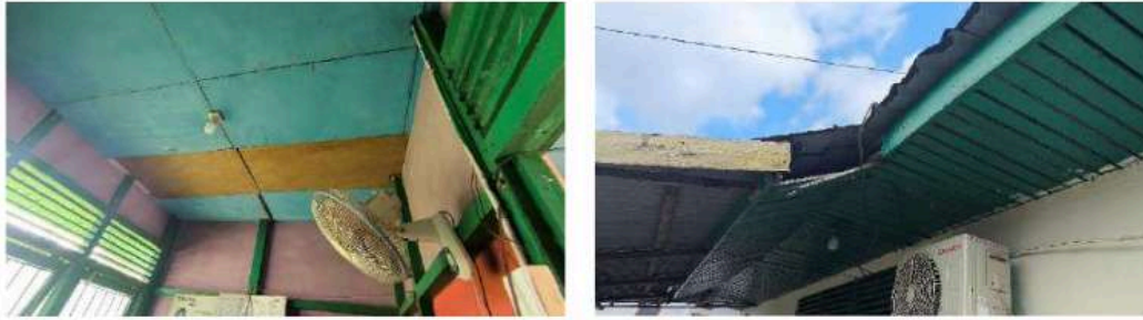
Gambar 4. 10 Kondisi Kerusakan Pada Instalasi Listrik
