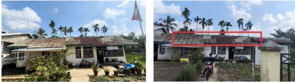
Gambar 4. 35 Kondisi atap di lapangan
