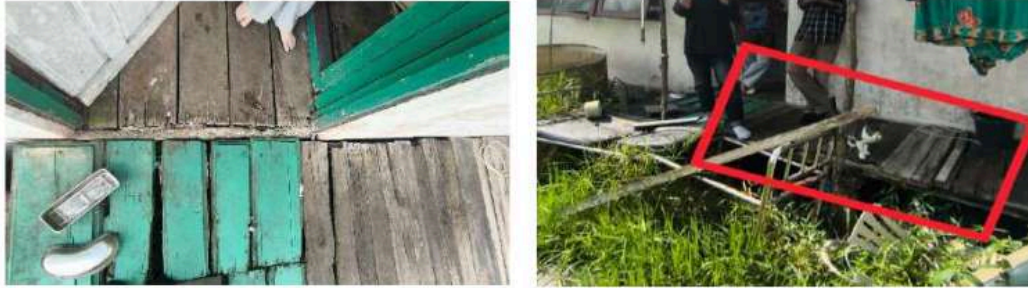
Gambar 4. 3 kondisi kerusakan pada lantai
