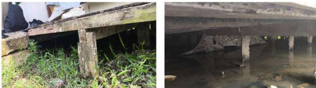
Gambar 4. 14 Kondisi tongkat kayu di lapangan
