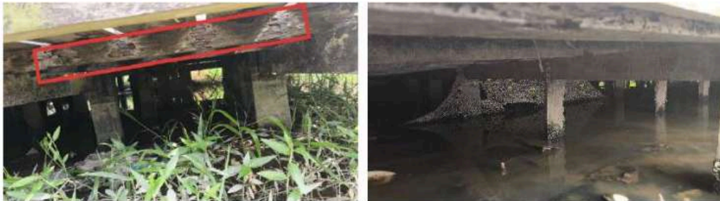
Gambar 4. 2 kondisi kerusakan pada pondasi
