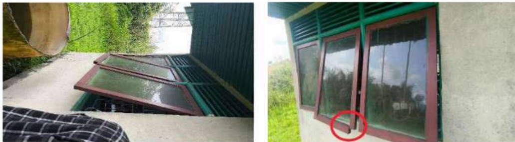
Gambar 4. 9 Kondisi Kerusakan Pada Jendela
