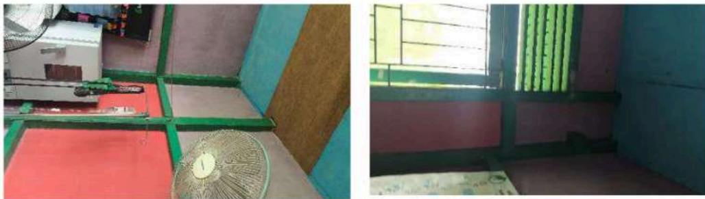
Gambar 4. 4 Kondisi Kerusakan pada kolom
