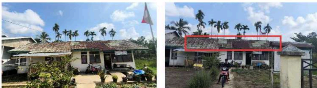
Gambar 4. 12 Kondisi Kerusakan Pada Atap
