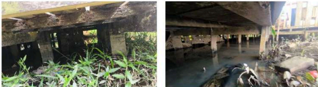
Gambar 4. 18 Kondisi gelagar di lapangan
