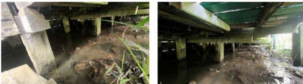
Gambar 4. 16 Kondisi kerusakan balok lantai di lapangan
