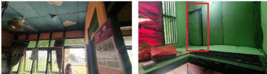
Gambar 4. 32 Kondisi plafon di lapangan
