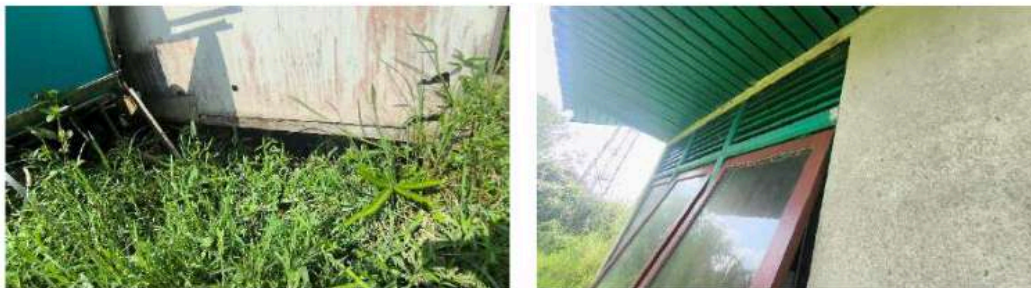
Gambar 4. 11 Kondisi Kerusakan Pada Finishing Dinding/Cat
