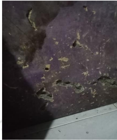
Gambar 2. 2 Kerusakan Sedang Sumber : Dokumentasi Pribadi
