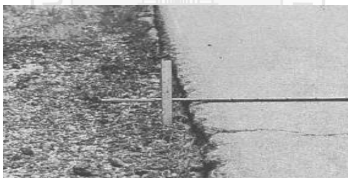
Gambar 2. 10 Penurunan bahu jalan
