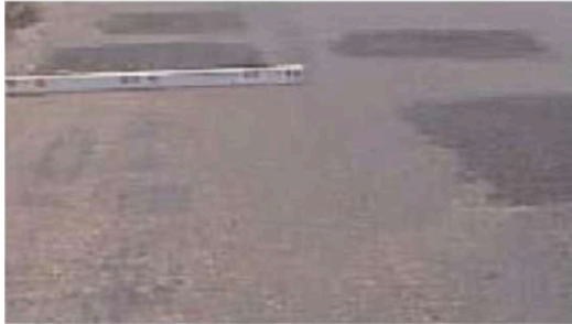
Gambar 2. 11 Tambalan dan galian utilitas
